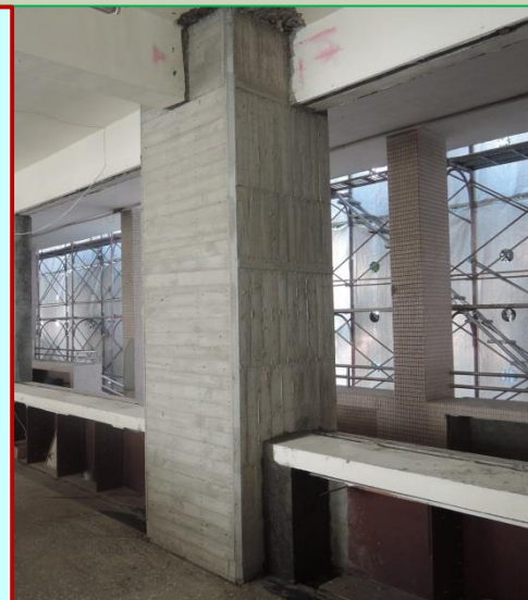
混凝土完成面良好無蜂窩
