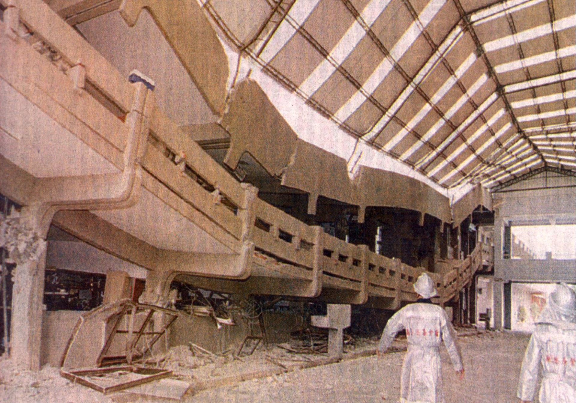
10/22 嘉義地震--民雄農工電工實習大樓塌陷破壞
