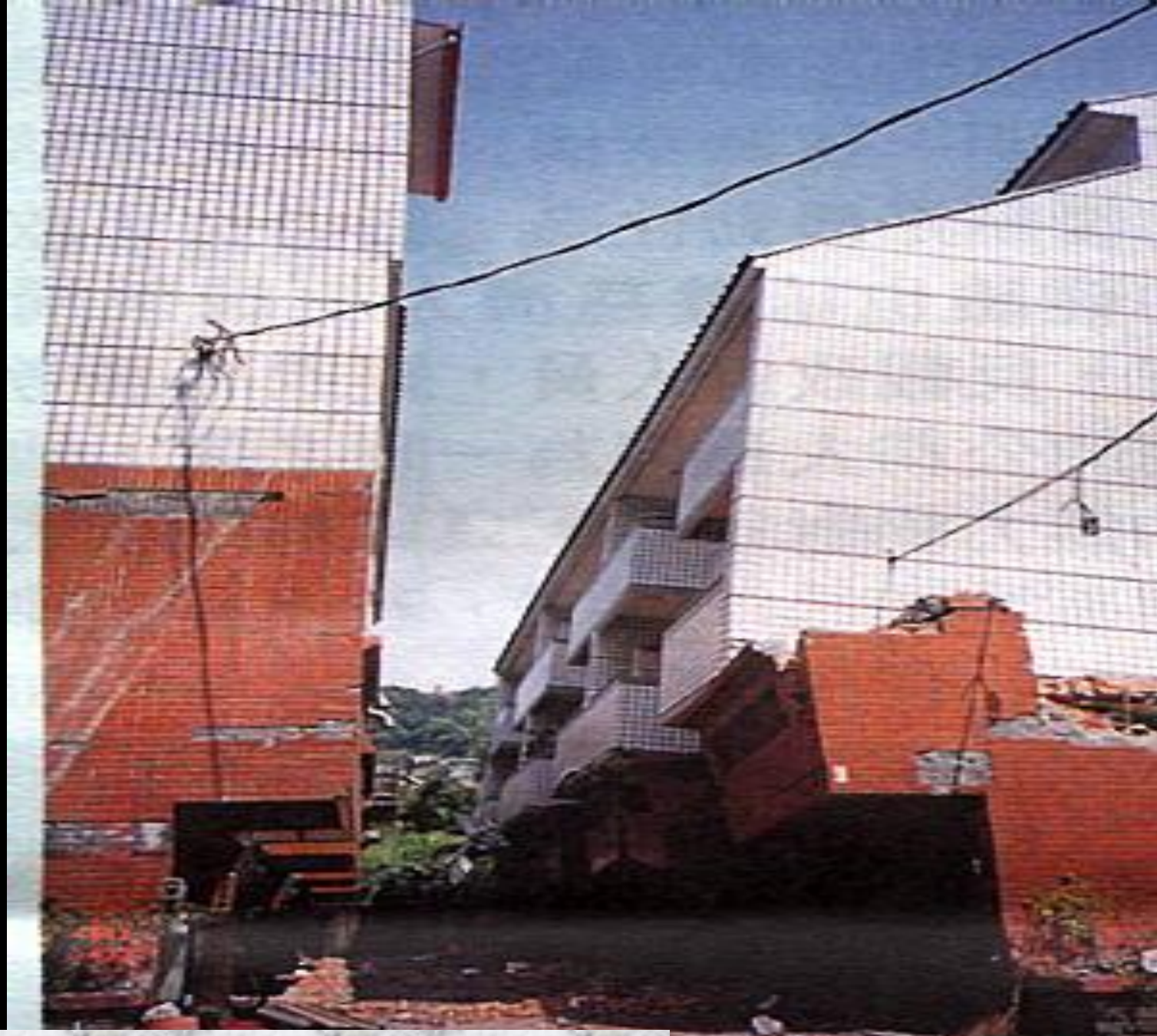
草屯民房--挑高樓層破壞塌陷
