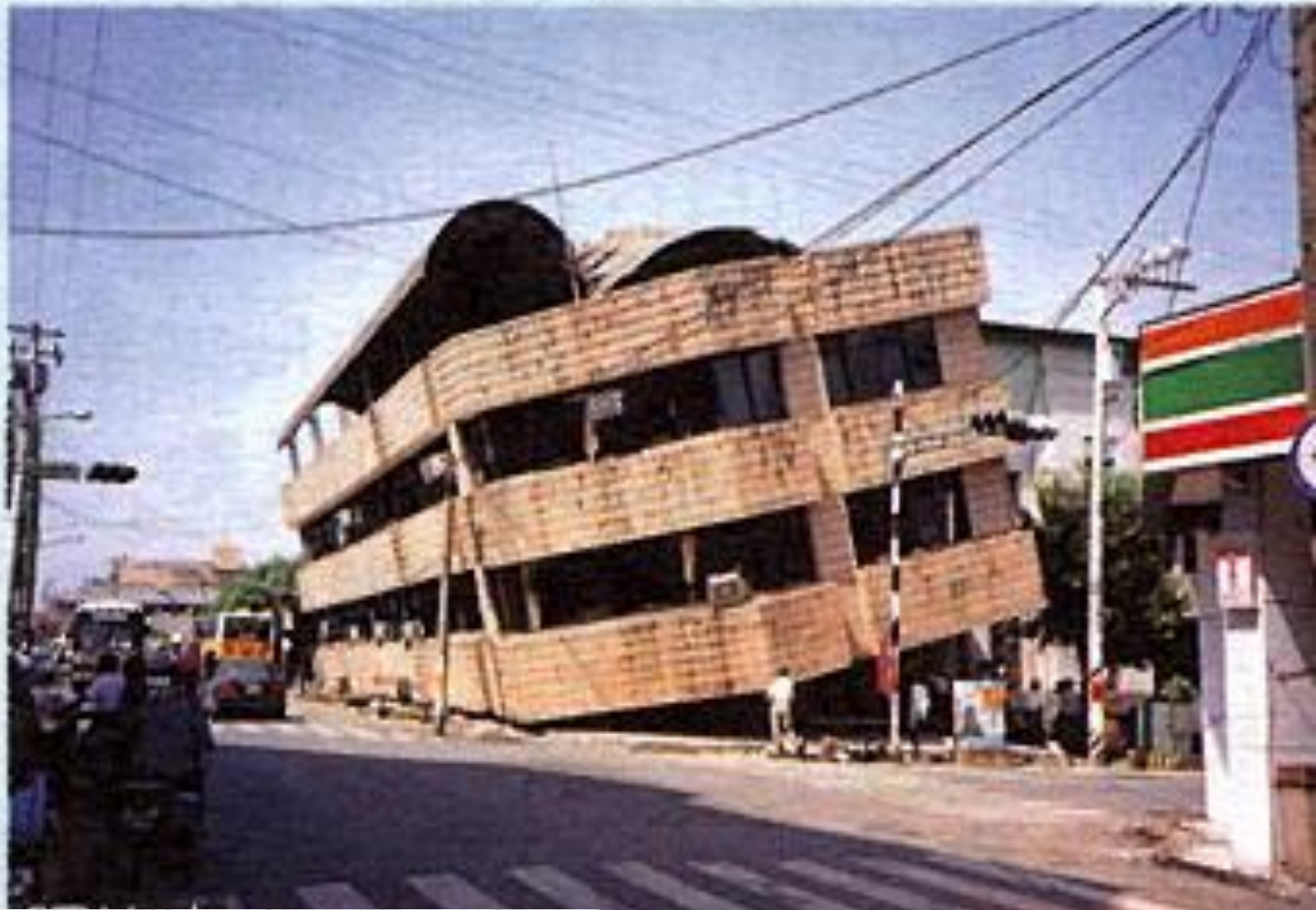
草屯民房--一樓騎倒塌樓破壞
