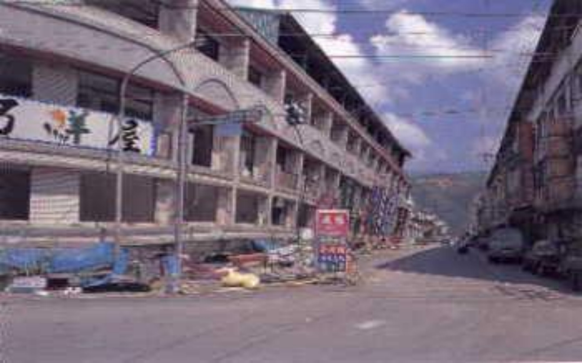
一般民房--一樓騎倒塌樓破壞
