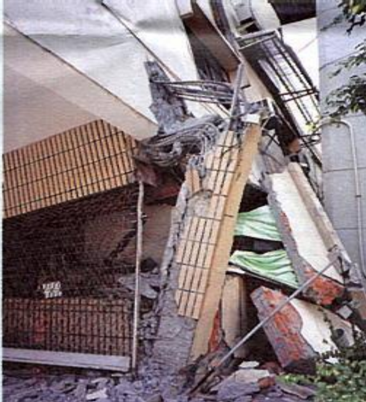
草屯民房--一樓柱破壞
