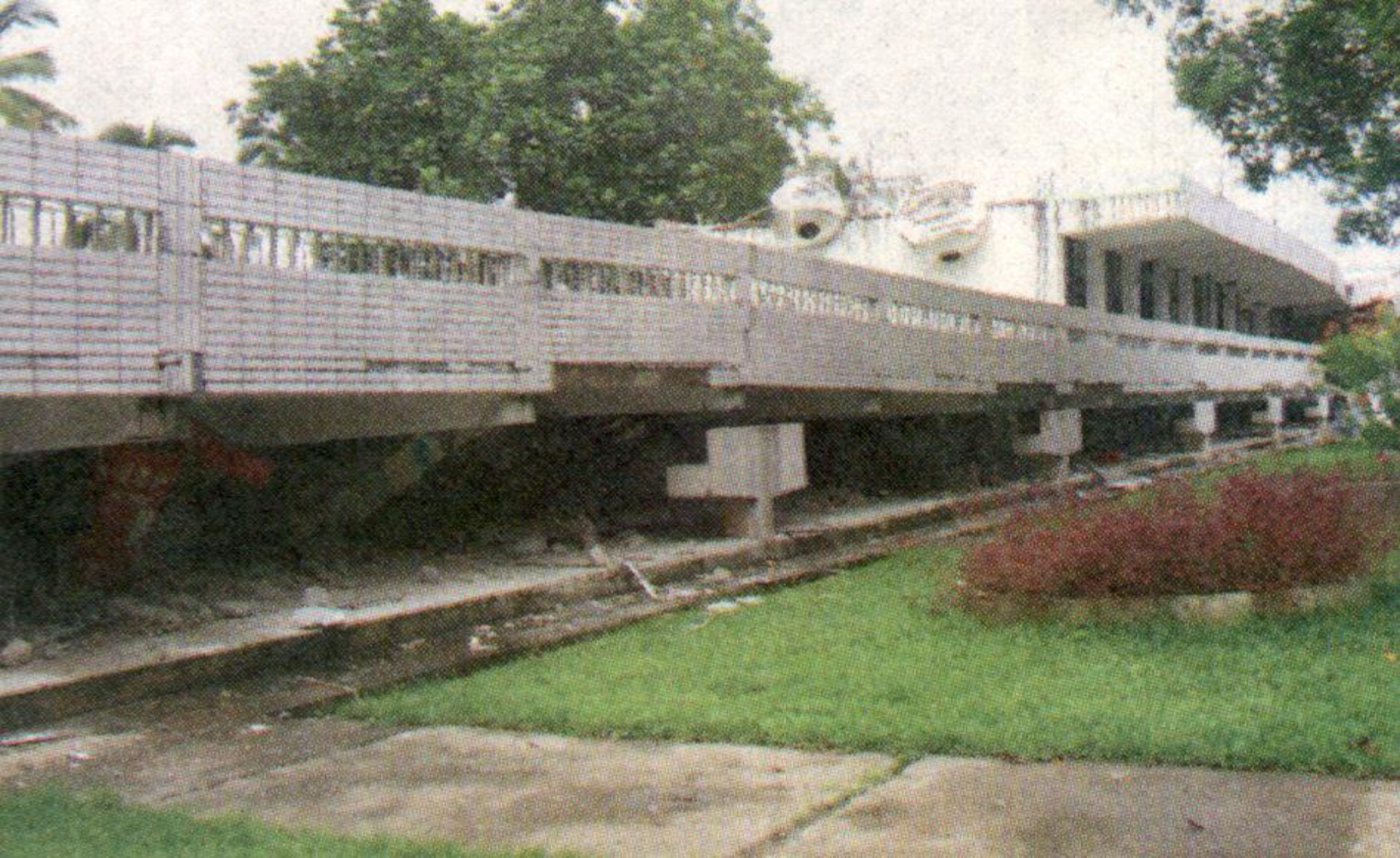
竹山社寮國小--一樓完全塌陷
