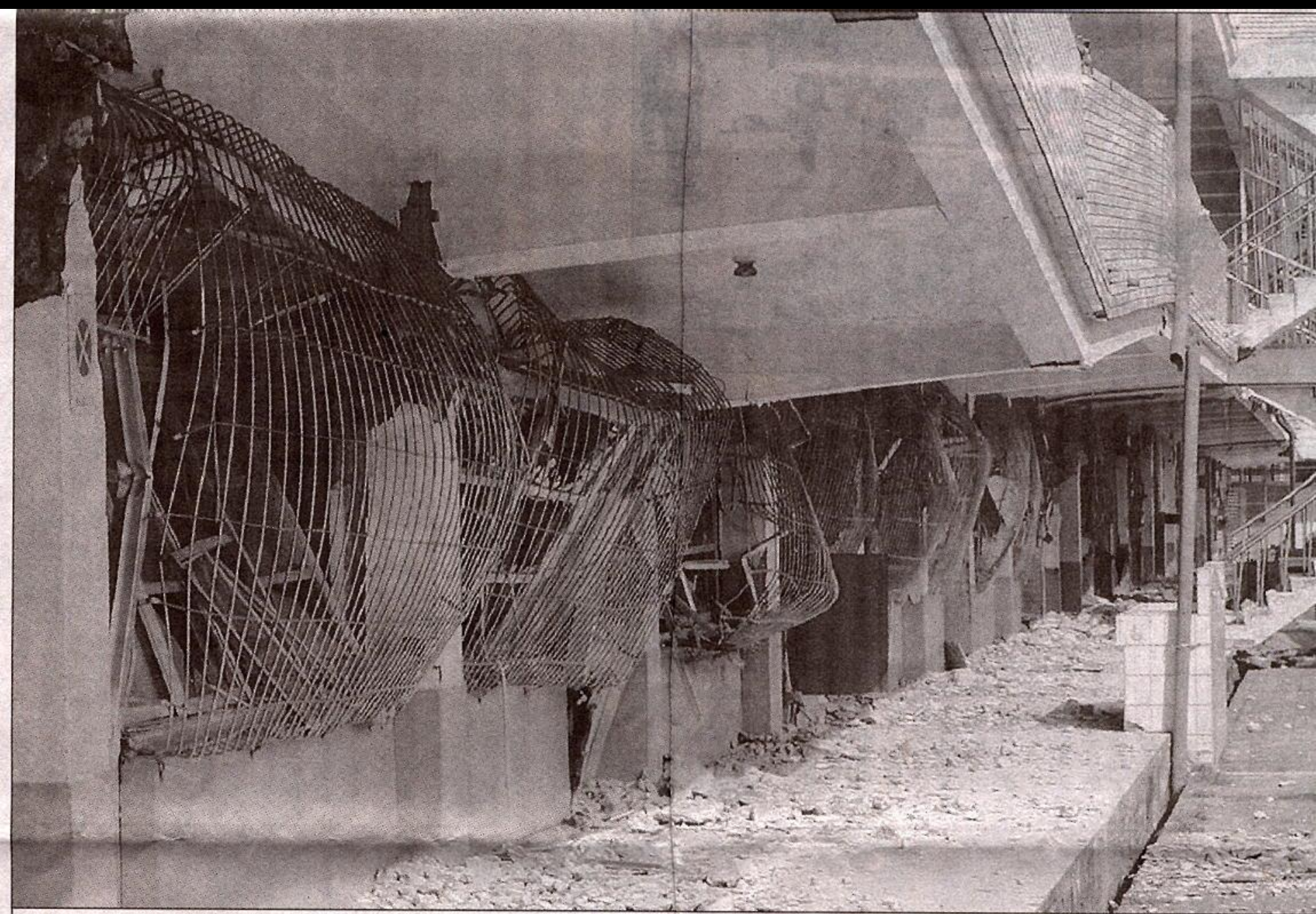
。形變重嚴壓擠被窗鐵樓一，垮震上以樓二舍校中國興中縣投南
