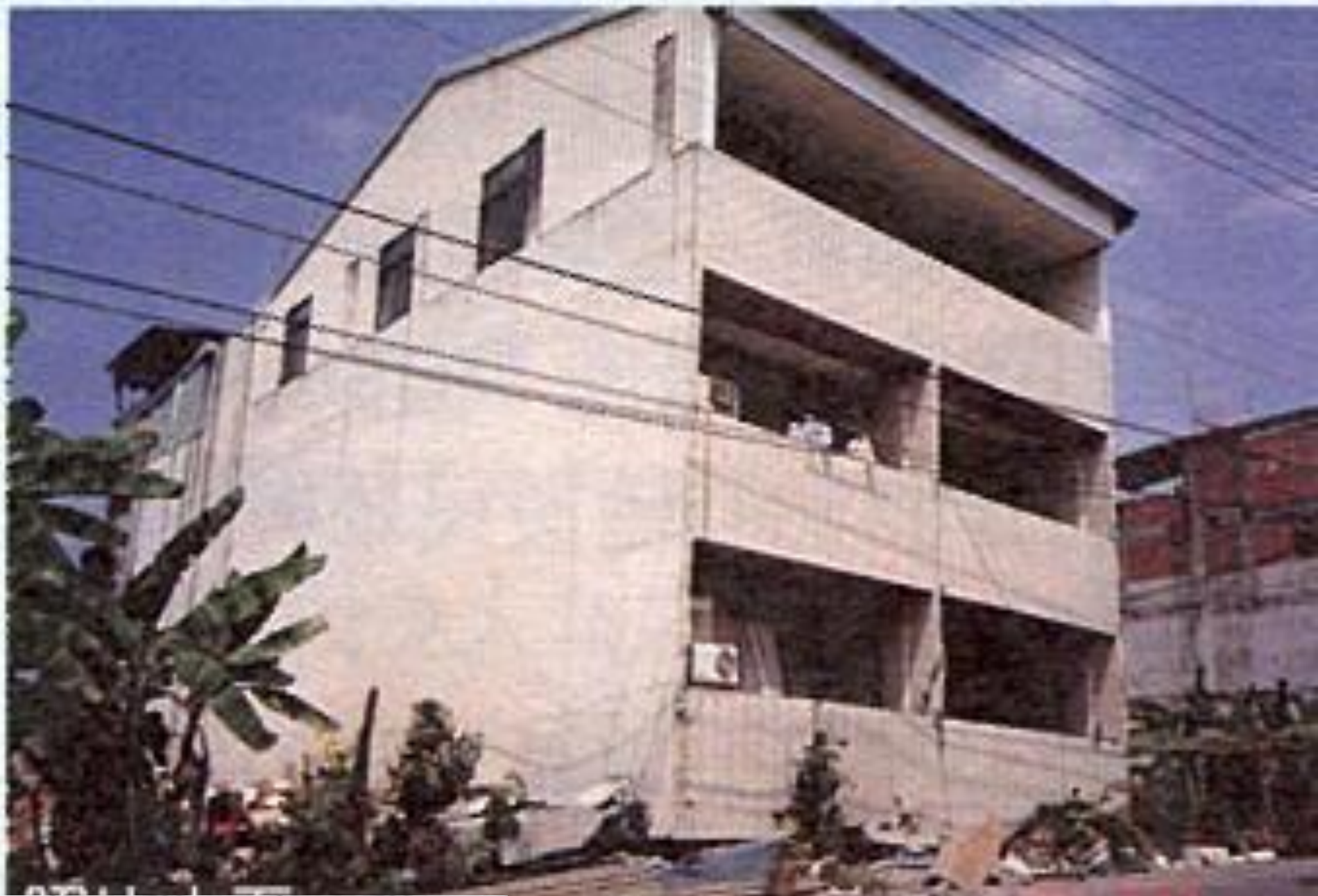
草屯民房--一樓完全破壞
