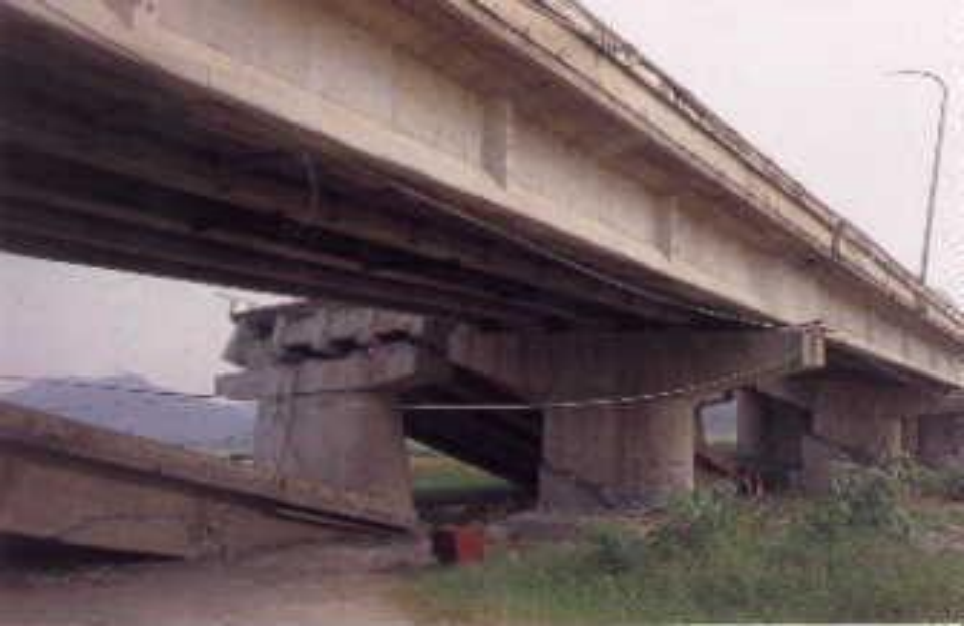
烏溪橋--橋墩剪裂錯動
