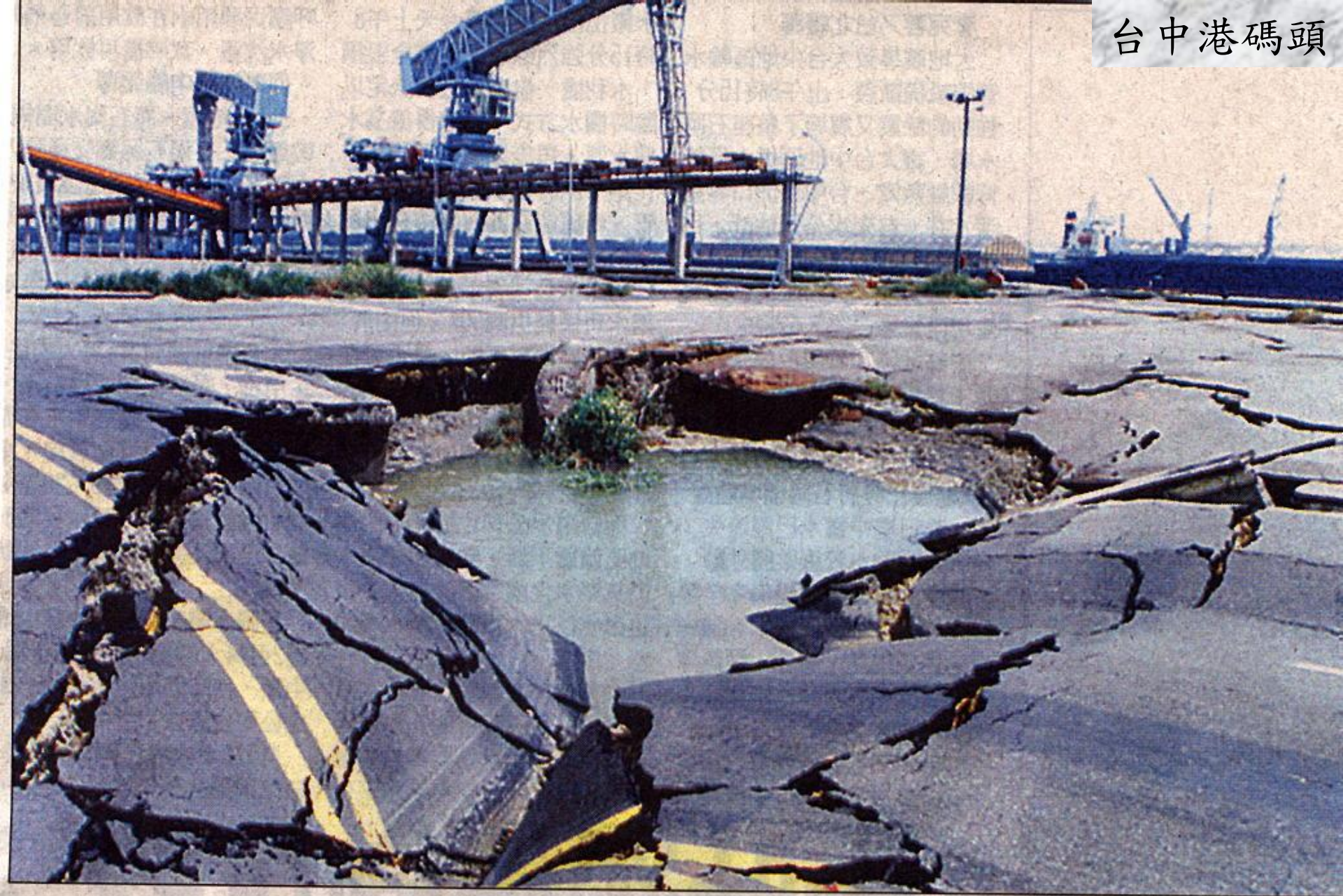
大地在哭泣 ■台中港碼頭嚴重坍塌，機具設備岌岌可危，損失慘重。
