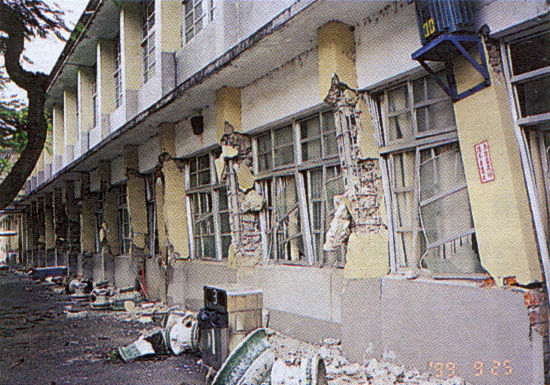
埔里南光國小--短柱破壞,箍筋間距太大,柱內有水管
