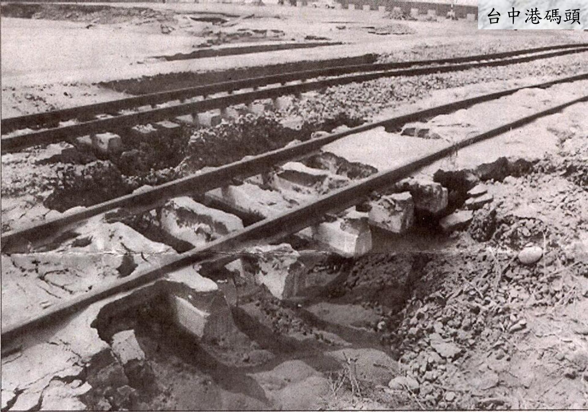
■台中港碼頭因液化造成坍陷，連鐵軌地基亦遭到掏空。
